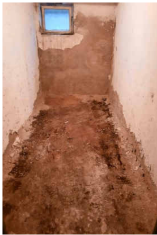
Vorher: Feuchtigkeit im Mauerwerk hat Schäden verursacht.
