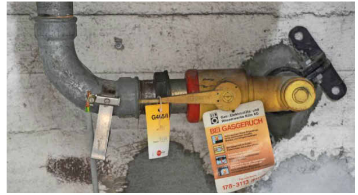
Wenn es nach Gas riecht, sollten der Haupthahn zuge dreht, die Fenster geöffnet und das Gebäude schnell verlassen werden. Foto: Jörg Carstensen/dpa
