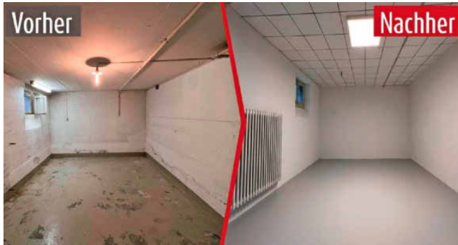
Jeder Keller kann noch gerettet und der weitere Feuchteintritt unterbunden werden.
