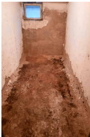
Vorher: Feuchtigkeit im Mauerwerk hat Schäden verursacht.
