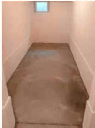
Nachher: Die sanierten Wände wirken wie neu. Fotos: privat
