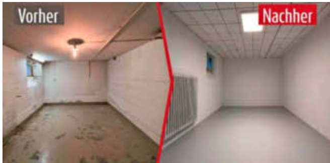
Jeder Keller kann noch gerettet und der weitere Feuchteintritt unterbunden werden.
