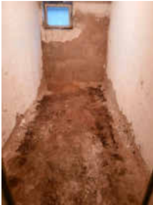
Vorher: Feuchtigkeit im Mauerwerk hat Schäden verursacht.
