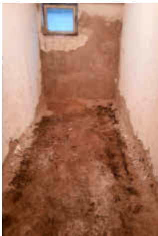
Vorher: Feuchtigkeit im Mauerwerk hat Schäden verursacht.
