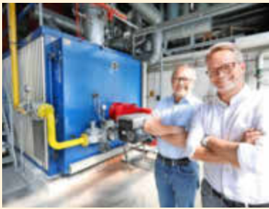
Geschäftsführer Peter Theilacker und Technischer Leiter Christian Hoch im Kesselraum. Foto: privat
