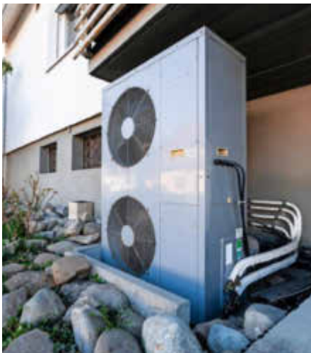
Auch Firmen müssen prüfen, ob sie auf Wärmepumpen umsteigen. Foto: dpa
