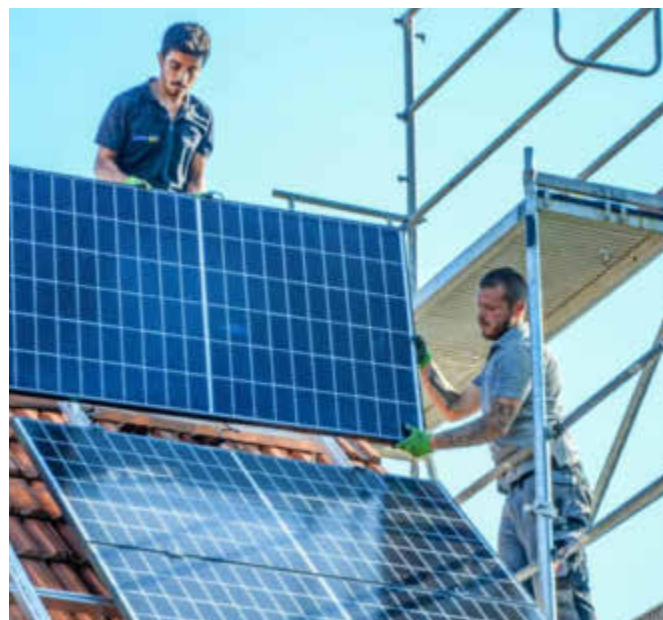
Von der Planung über die Montage bis zur regelmäßigen Wartung: Das Team von KlarModul punktet mit einem breiten Angebot. Foto: privat
