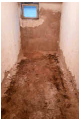
Vorher: Feuchtigkeit im Mauerwerk hat große Schäden verursacht.
