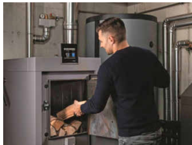
Die Erneuerung Ihrer Heizungsanlage kann nicht nur die Energiekosten reduzieren, sondern auch die Umwelt schonen. Foto: privat
