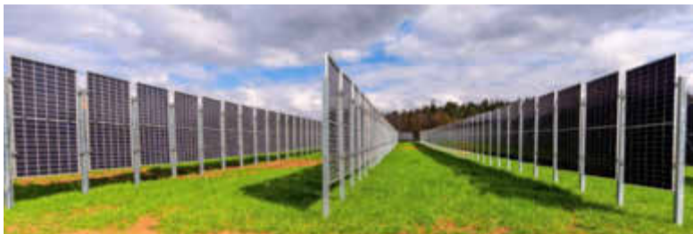
Eine Agri-PV-Anlage in Reisbach, Bayern, die von CWF im Jahr 2023 gebaut wurde.
