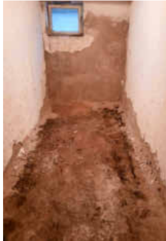
Vorher: Feuchtigkeit im Mauerwerk hat große Schäden verursacht.
