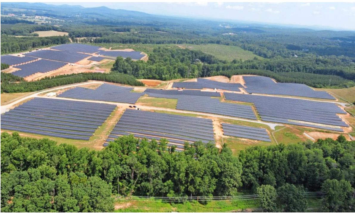
Auf der ganzen Welt hat die hep-Gruppe mehr als 80 Solarprojekte und 30 Solarparks im eigenen Betrieb. Auch in Eppingen und Crailsheim entstehen bald Freiflächenprojekte mit einer Gesamtleistung von 50 Megawatt Peak.
