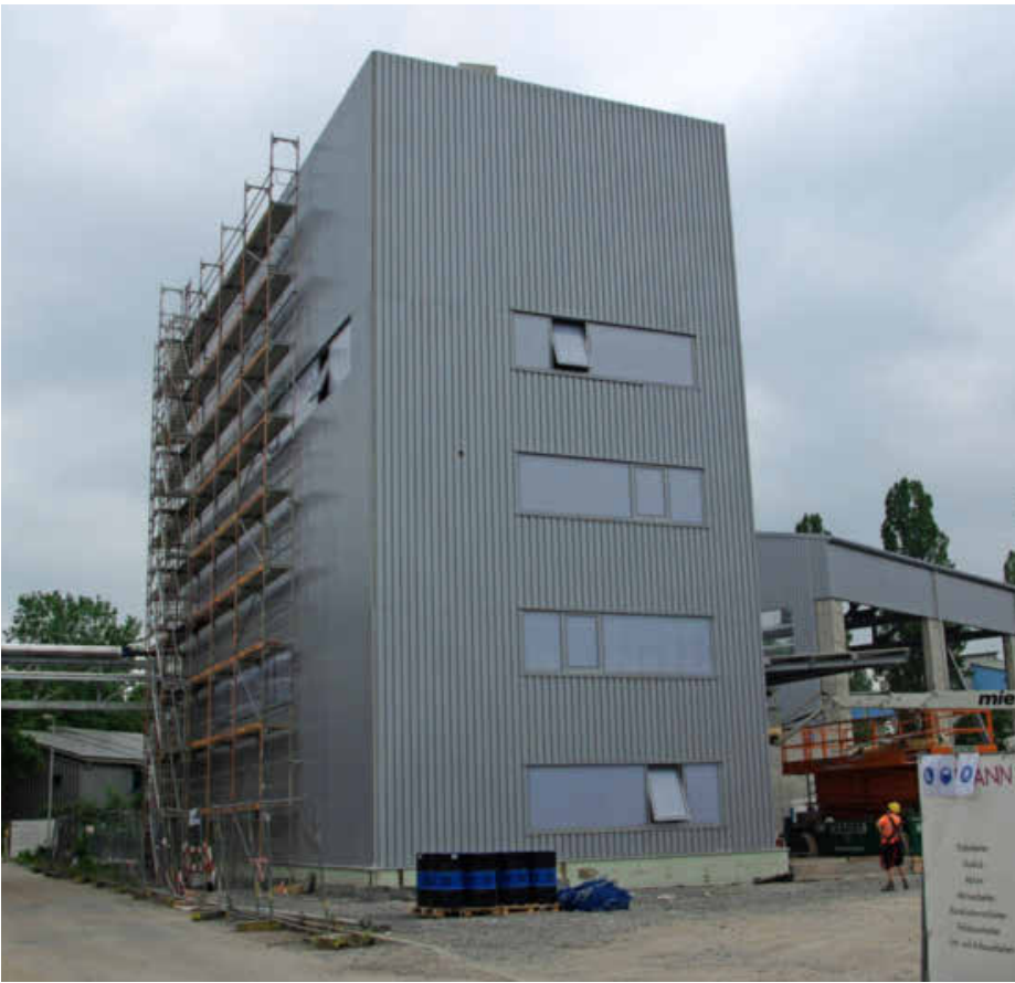
Direkt neben dem Werk von Brüggemann ist in den vergangenen Monaten ein Biomasse-Kraftwerk gebaut worden. Foto: Heiko Fritze
